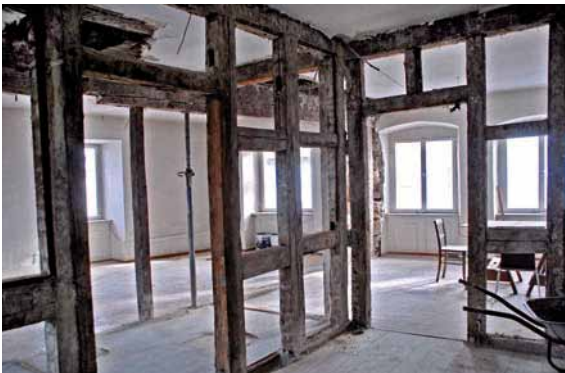
Abb. 5: Blick in den jetzigen Saal vor der Entkernung aller Räume in diesem Bereich.
