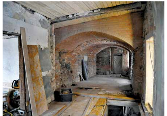
Abb. 16: Blick durch den neuen Teil des Gewölbes (vorne) auf den freigelegten Durchgang und das entkernte Treppenhaus.
