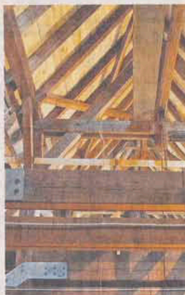
Mit Stahlseilen und -Platten verstärkt: Der Dachstuhl in St. Nikolaus. Foto: msb
