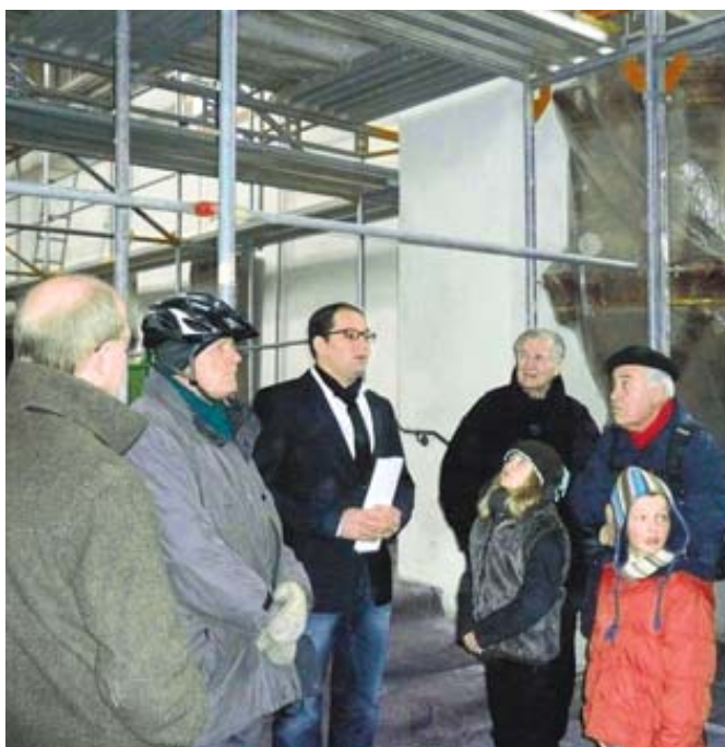
Andreas Flöß (Dritter von links) erläutert beim einem Rundgang durch die Sanierungsbaustelle Johanneskirche den Sachstand der Renovierungsarbeiten.
