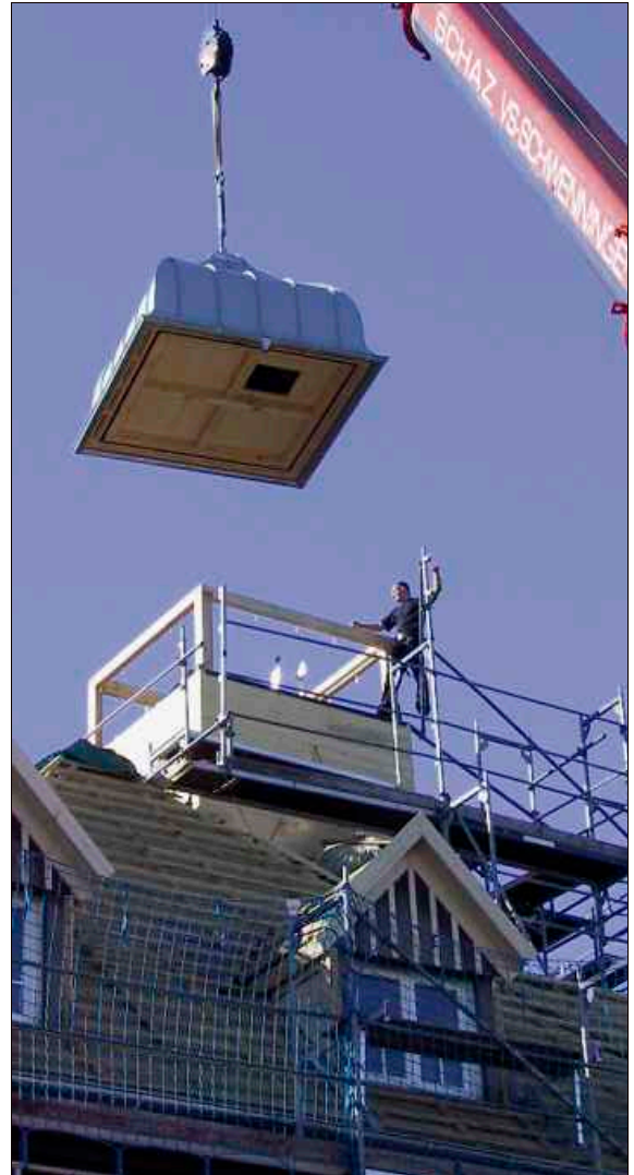
Das Türmchen schwebt auf seinen Bestimmungsort zu. Der Autokran leistet ganze Arbeit. Fotos: Streck
